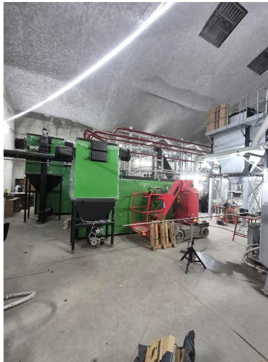
Chaufferie bois de Saint-Symphorien-sur-Coise
