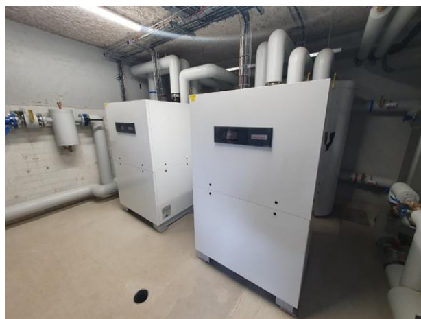
Pompes à chaleur géothermiques – Halle Bointon – Villefranche-sur-Saône
