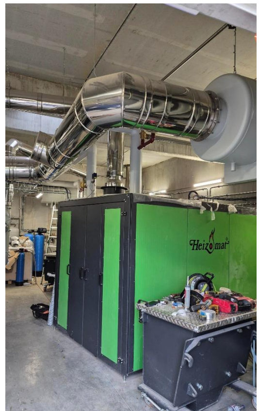
Chaufferie bois de Loire-sur-Rhône
