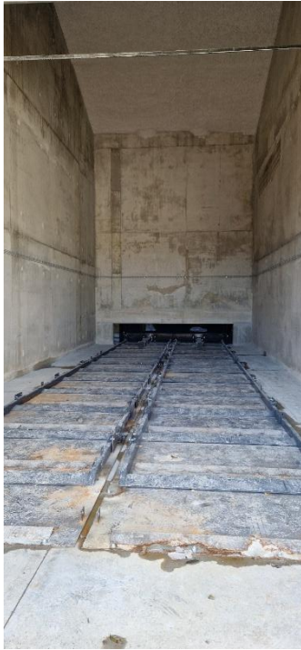
Silo à bois de la chaufferie de Saint-Symphorien-sur-Coise
