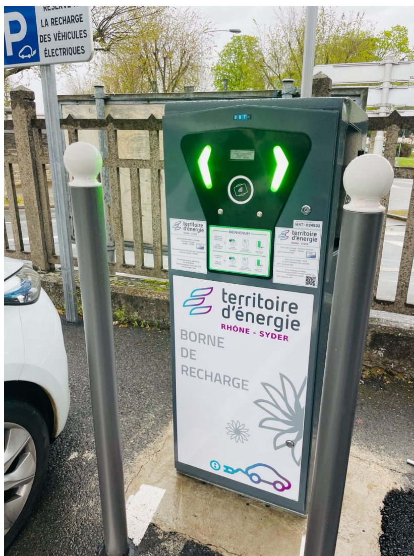
Photo d'une borne IRVE du SYDER
